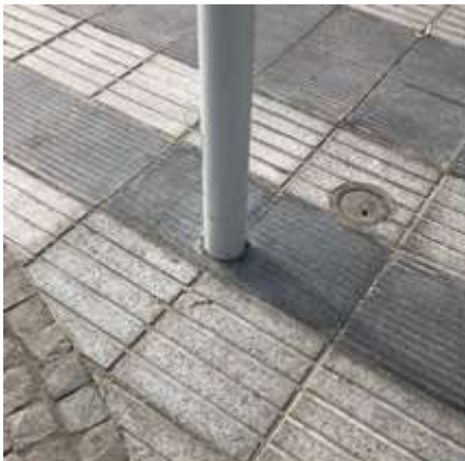
Imagen típica de poste y cámara con zona con piso terminado
