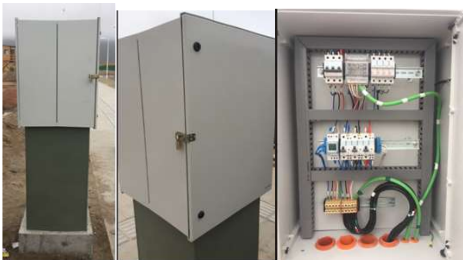
Apariencia esperada de tablero de medida y control sobre soporte
